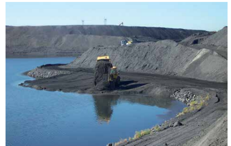
Figure 2 Pour créer des roselières, l'EPF a procédé à l'adoucissement des berges de l'étang des Argales © G. LEMOINE.
