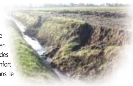
Effondrement des berges suite à un reprofilage excessif du fossé
